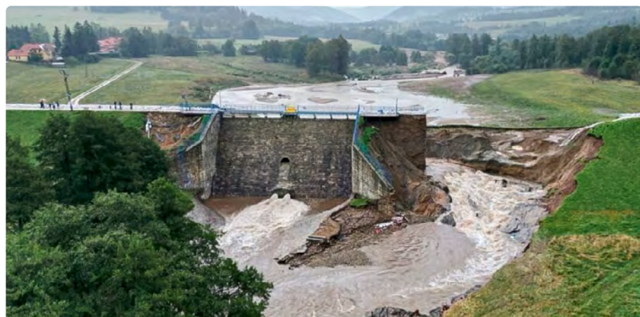
Fot. 2. Zapora w Stroniu Śląskim – stopień zniszczeń części ziemnej
