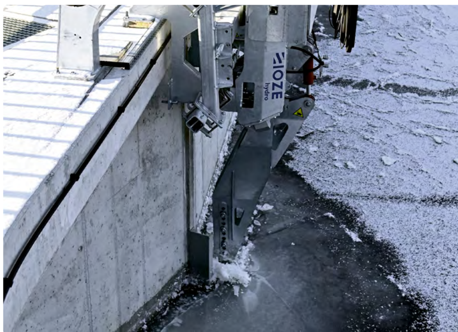
Fot. 6. Czyszczarka krat poziomych wspomagająca pracę obiektu
