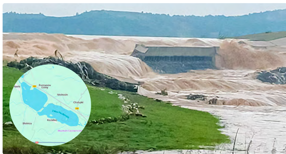
Fot. 1. Awaria przepustu między zbiornikiem Topola i Kozielno (w kółku usytuowanie obu zbiorników)
