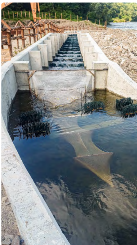
Fot. 10. Widok na zamontowaną na przepławce pułapkę (m. Wadowice, rz. Skawa)
