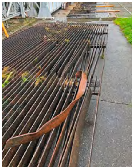
Fot. Przykład uszkodzeń krat
