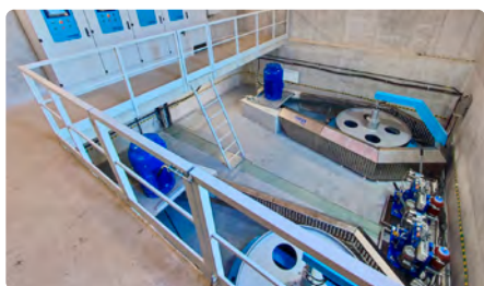
Fot. 4. Wnętrze MEW z dwoma hydrozespołami i platformą sterowniczą
