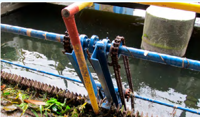
Czyszczarka krat zamontowana na wlocie do turbin wodnych bez zabezpieczeń strefy zagrożenia: stref pracy kół zębatych.
