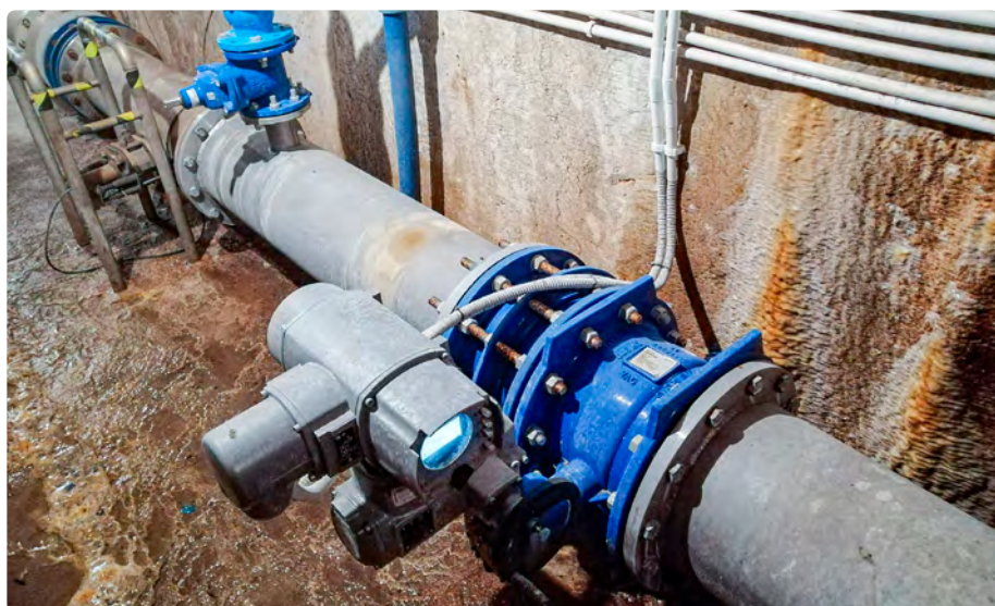
Fot. 4. Przepustnica regulacyjna w prawej sztolni na rurociągu DN 300
