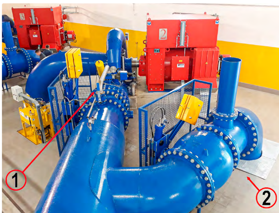
Fot. 5. Przykład realizacji elektrowni wodnej z zastosowaniem armatury T.I.S.: 1 – przepustnica podwójnie mimośrodowa z cylindrem hydraulicznym i przeciwwagą, wraz ze wstawką montażową, 2 – zawór iglicowy z cylindrem hydraulicznym i przeciwwagą, wraz z urządzeniem napowietrzającym
