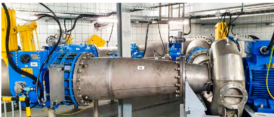
Fot. 8. Armatura T.I.S. zainstalowana w małej elektrowni wodnej w Zakładzie Produkcji Wody „Pomorzany” (ZWiK Szczecin)
