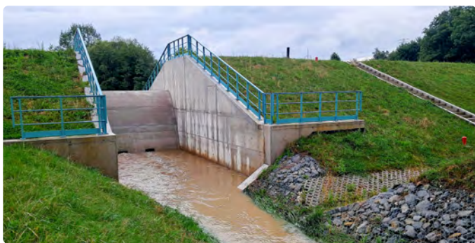
Fot. 9. Zapora suchego zbiornika Malinówka 1 w Krakowie (zapora ziemna, żelbetonowe urządzenia przelewowo-upustowe)
