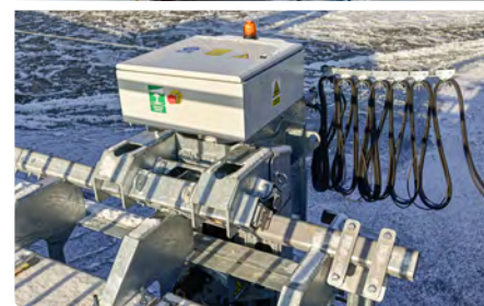
Fot. 7. Od góry: wewnątrz szafy sterowniczej, skrzynka sterownicza czyszczarki krat
