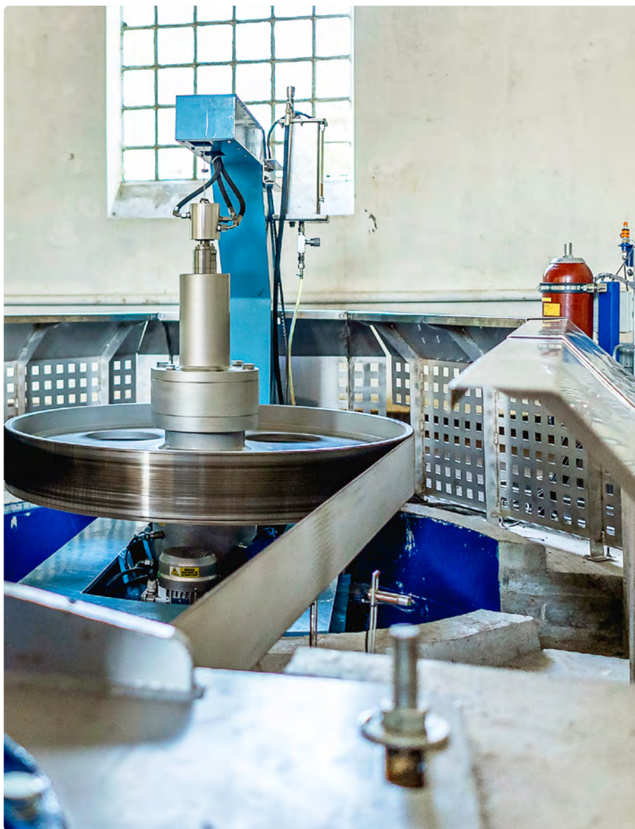
Fot. 4. Jeden z dwóch nowych układów prądotwórczych w MEW Niedalino
