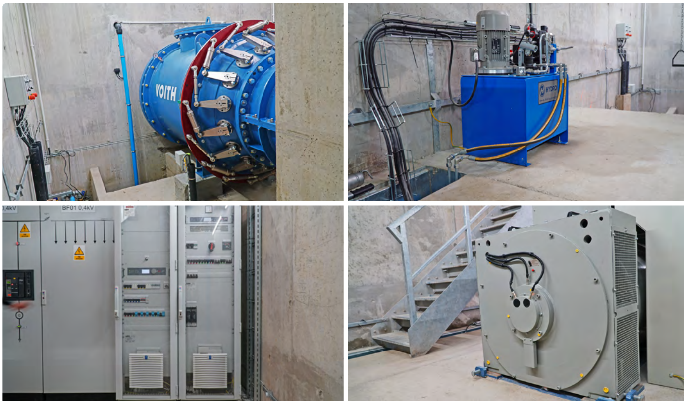
Fot. 3. Kluczowe elementy wyposażenia MEW: turbina wodna, zasilacz hydrauliczny, szafy elektryczne/regulator turbiny, generator synchroniczny
