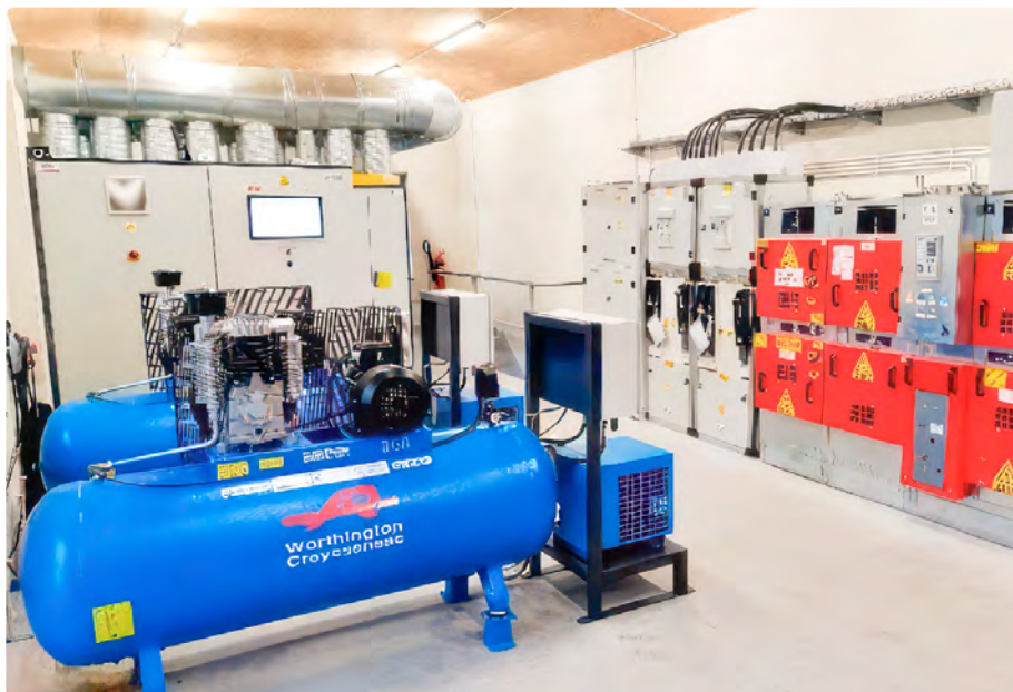
Fot. 7. Wnętrze budynku MEW – regulator turbiny wraz z wyprowadzeniem mocy
