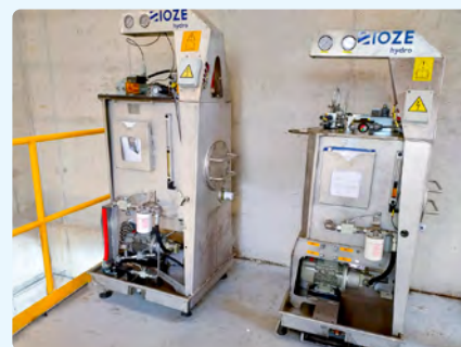
Fot. 4. Zasilacze hydrauliczne jazu i turbiny
