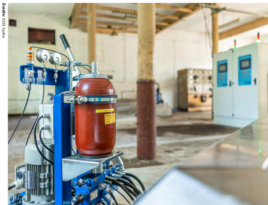
Fot. 5. Agregat hydrauliczny, w tle nowe szafy sterownicze i historyczne elementy wyposażenia młyna
