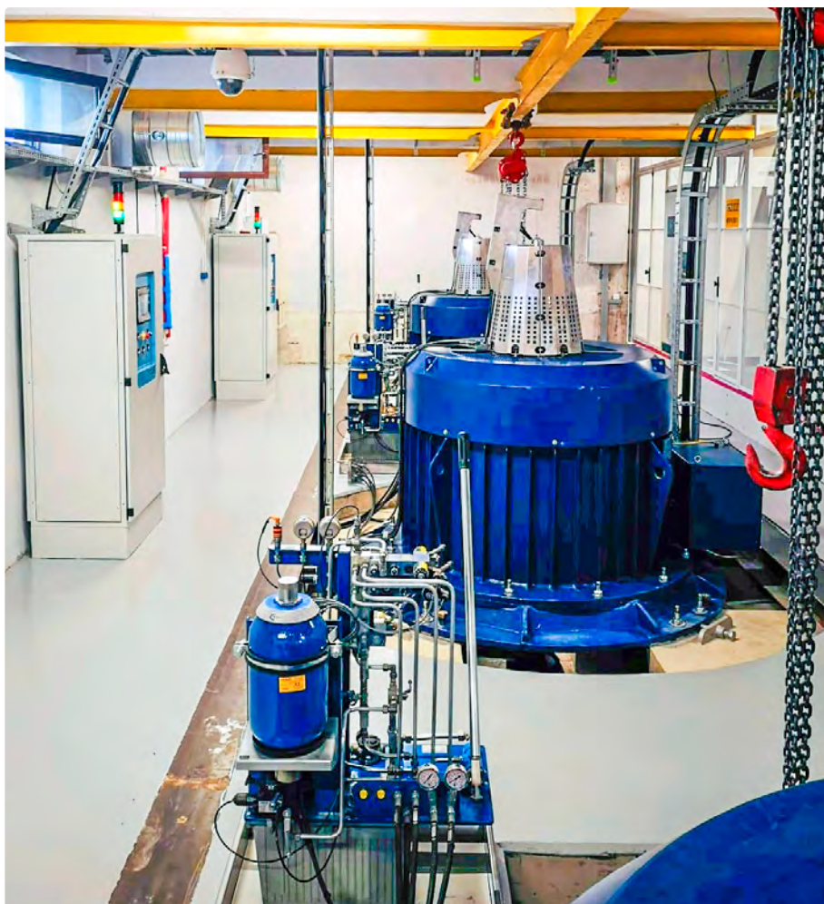
Fot. 6. Wnętrze obiektu po repoweringu
