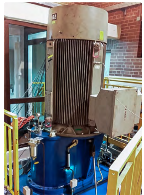
Fot. 2. Generator hydrozespołu o osi pionowej
