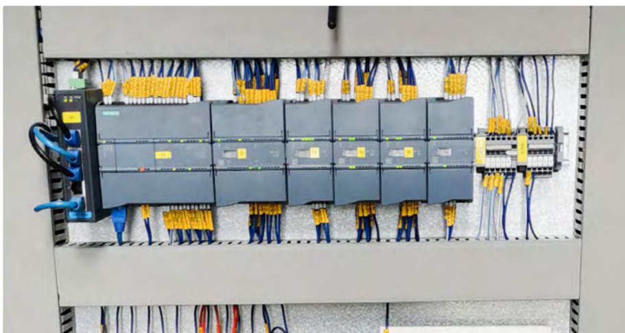
Fot. 5. Widok wnętrza szafy sterowniczej
