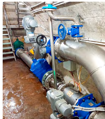
Fot. 3. Sposób zabudowy hydrozespołu w Wapienicy
