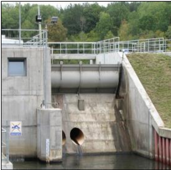
Rysunek 64: Kłapa przelewowa z osią obrotu umieszczoną na koronie jazu w Małej Elektrowni Wodnej Rzeczyca na rzece Wierzycy, Polska (źródło: J. Steller)
