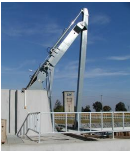
Rysunek 59: Przegubowe urządzenie do czyszczenia kraty wlotowej w Małej Elektrowni Wodnej Januszkowice na Odrze, Polska (źródło: J. Steller)
